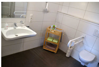
WC, Dusche, Waschraum
