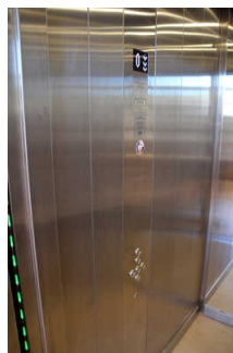
Aufzug am Eingang
