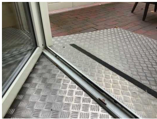
Rampe über Türschwelle
