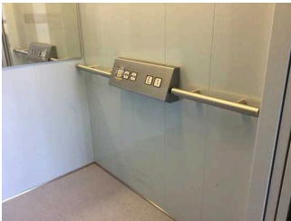
Aufzug zwischen Eingang und Ferienwohnung im Obergeschoss
